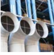
HVACR/楼宇自控 第12页
