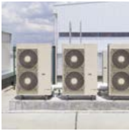
冷却装置/热交换器 差压传感器为冷却装置提供流量指示，差压越大，流量越高。LVDT用于压缩机滑阀位置反馈。
